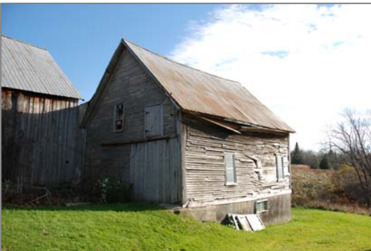
Un bâtiment abandonné, comme cette ancienne écurie, se détériore très rapidement.
