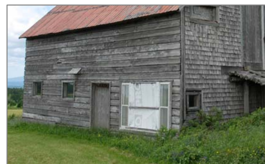
La nouvelle ouverture s'intègre mal et ne respecte pas les alignements et les modèles des portes et des fenêtres existantes.
